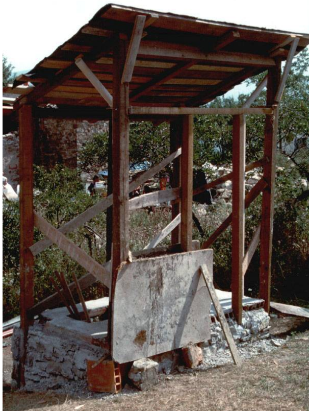
Gabinetto esterno a doppia camera tipo vietnamita realizzato a Granara: segatura e cenere in aggiunta, urine prevalentemente nei campi
